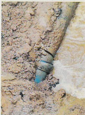
Zdjęcie uszkodzenia wodociągu
